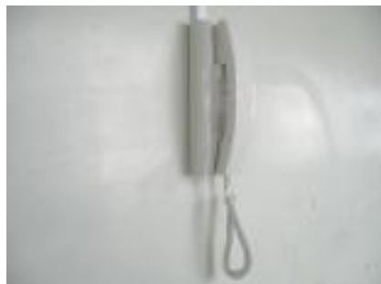
非常通報用インターホン
